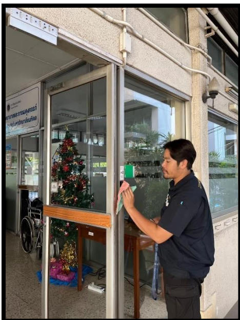
ตรวจการทำงานของระบบ Access Control
