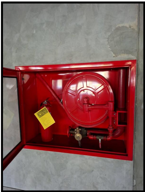
ตรวจสอบอุปกรณ์ตู้ดับเพลิง
