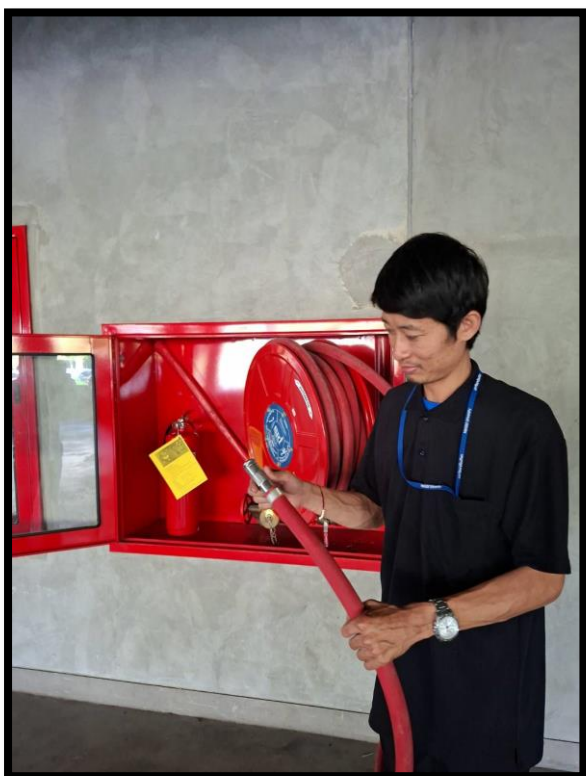
ตรวจสอบสายฉีดน้ำตู้ดับเพลิง
